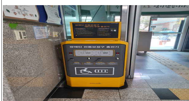
전동보장구 급속충전기 설치 (거여2동)
